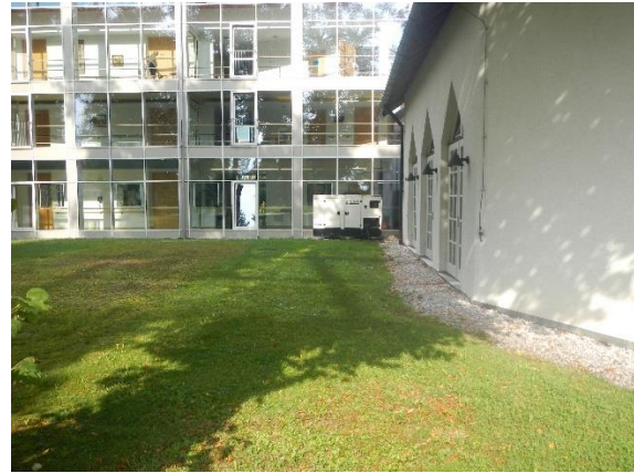
Abbildung 2.8: Notstromaggregat Seniorenwohn- anlage (Ortseinsicht am 09.08.2024)
