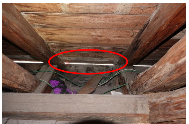
Abbildung 12: Schmalen Spalt zwischen Dachkonstruktion und Außenmauer.
