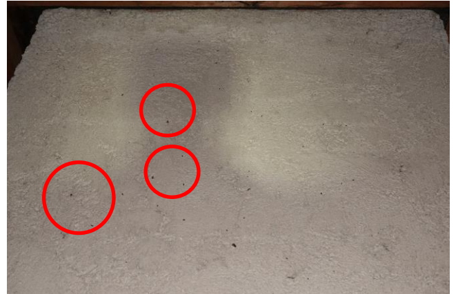
Abbildung 14: Kotpellets an der Kaminwand.
