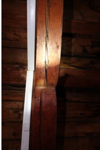
Abbildung 13: Risse in den Kehlbalken sind als Spaltenquartier für Fledermäuse geeignet.
