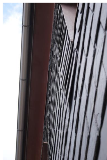
Abbildung 8: Einige der Schieferplatten weisen kleine wenig tiefe Spalten auf. Eine Nutzung durch Fledermäuse ist unwahrscheinlich.
